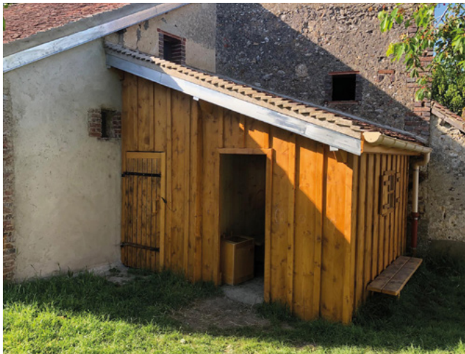
En haut : travaux à l'entrée du village, rue Chaude ; nouvelles huisseries pour le bureau de la mairie. En bas : la cabane de l'école. Photos Stéphane Rouet
